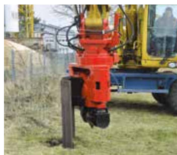
Переставить захжим на верхнюю часть шпунтового профиля и забить до заданной глубины
